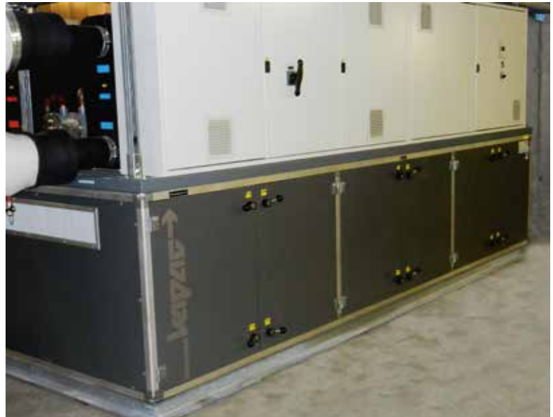
Die 2-stufige Hochtemperatur-Wärmepumpe.
