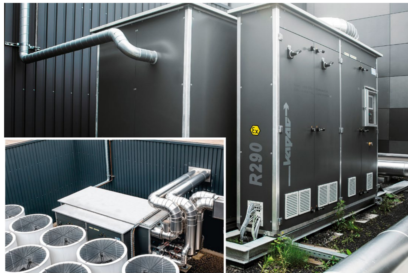
Abbildung 1: Aufstellungsort der Maschine auf dem Dach.
